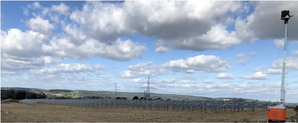
Abb. 5: Blick über die Anlage Vohenstrauß noch ohne Module
