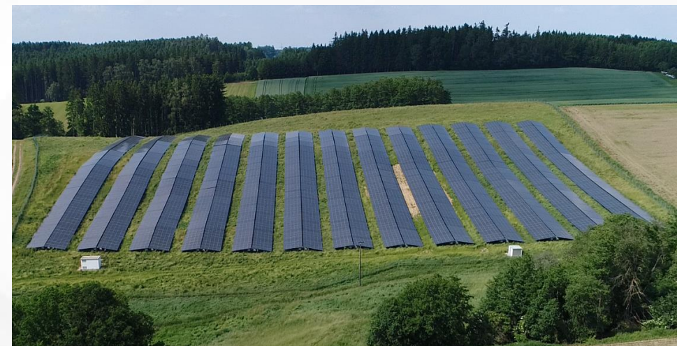
2,9 MWp Bürgersolaranlage Niederbergkirchen / Bayern
