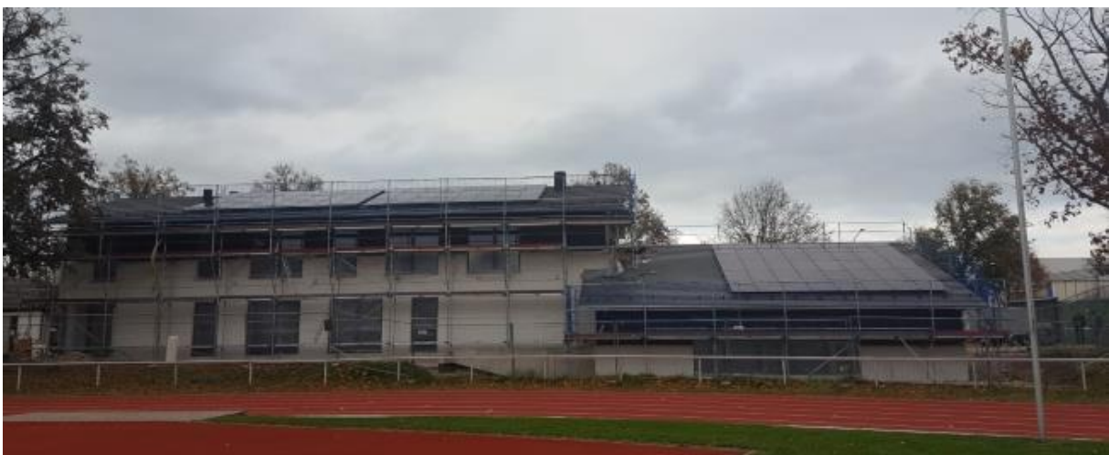
Haus des Sportes in Altötting, Quelle: MaxSolar GmbH
