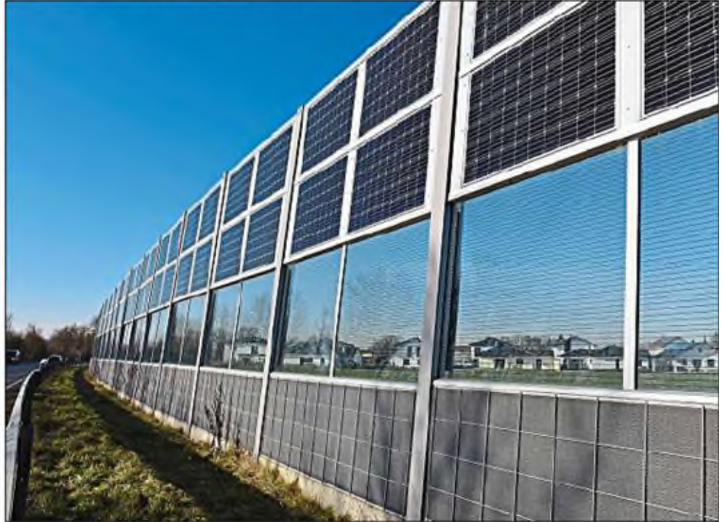
Die PV-Lärmschutzwand in Neuötting an der alten B 12 hat sich bewährt. Darum nennt sie MdL Martin Huber als Beispiel für gelungenen Lärmschutz, mit dem man auch Strom erzeugen kann. – Foto: Richter
