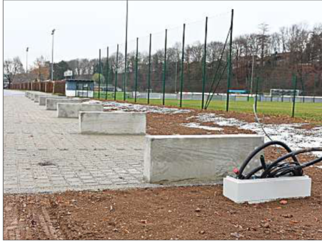
Die Fundamente sind fertig, erste Kabel sind verlegt. Bald beginnt in Neuötting das Egis-Carport-Projekt. – Foto: Richter
