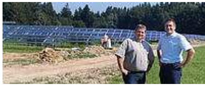
Zufrieden mit dem Baufortschritt ihrer Photovoltaik-Anlage: Werner Steinbrunner (l.) und Wolfgang Straubinger, die in der Geschäftsleitung der Rösler blue dafür zuständig sind. Im Moment werden die Solarmodule montiert. – Foto: Bernard
